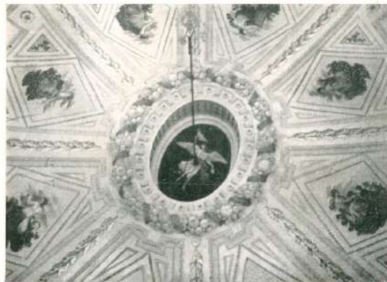
Fot. Selmi, Faenza. SOFFITTO DEL SALOTTO DEL 700 ALLA VILLA CARDELLO.
