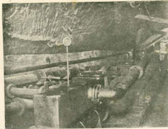
(Fig. 8). POMPA A VAPORE IN FONDO ALLA MINIERA.
